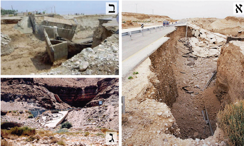
איור 1: נזק לתשתיות עקב התחרות הנחלים א. כביש 90 בחציית נחל דרגה לאחר שיטפון ב־2003; ב. קריסת גשר על נחל ערוגות ב־2001 (תצלום: י" ברטוב); ג. מעביר מים קרוס בנחל ישי.
